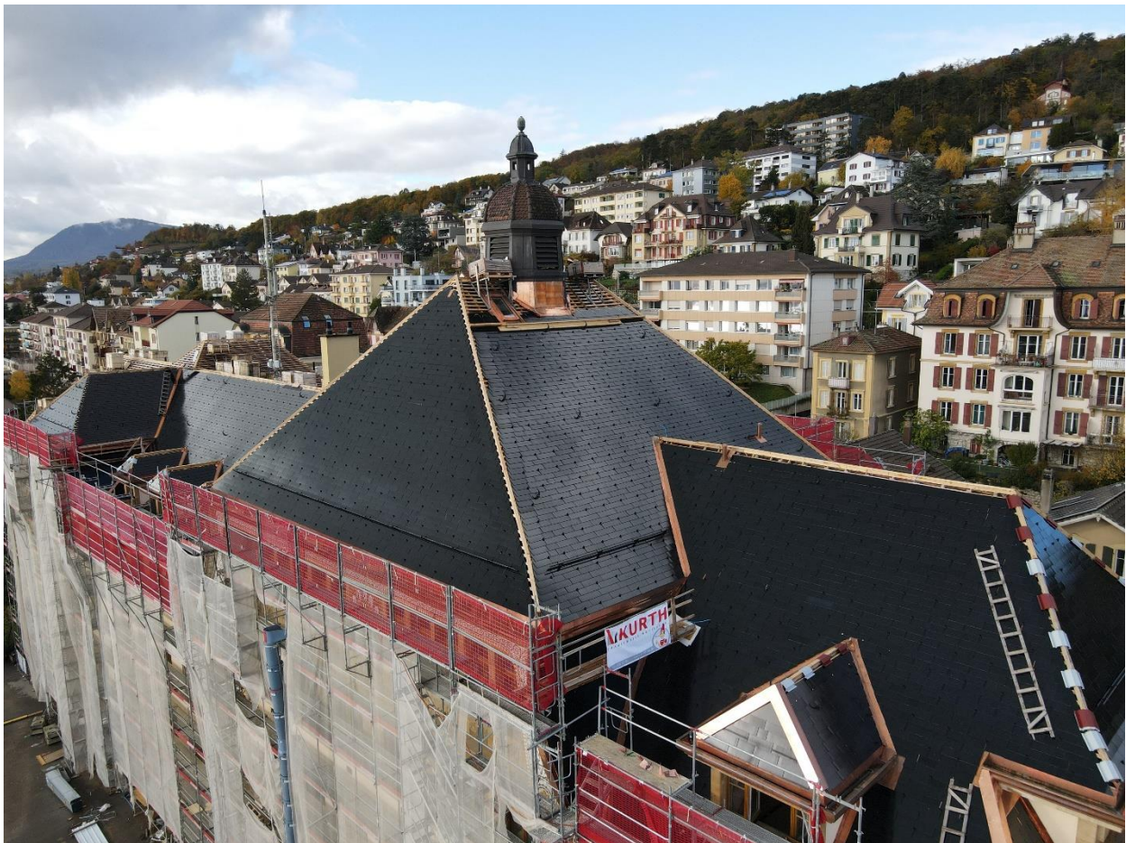
Das Collège des Parcs in Neuenburg verfügt nun über ein aktives Dach dank Tausenden von Solarziegeln. Diese wurden von CSEM und Freesuns entwickelt.
